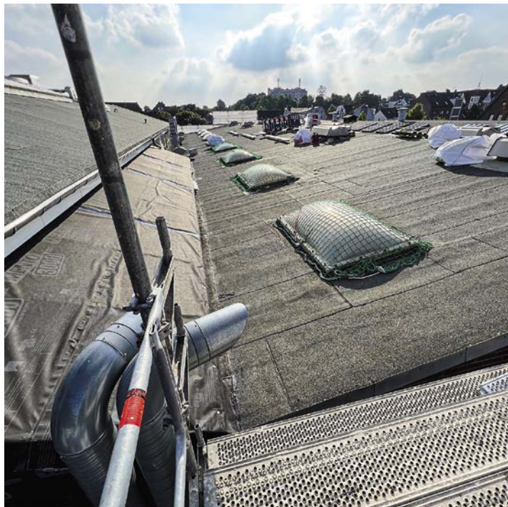
Personenauffangnetze sind oberhalb der alten Lichtkuppeln als Durchsturzschutz montiert und mit einem Spanngurt gesichert.
