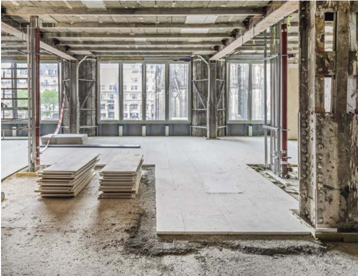
Nach dem Höhenausgleich durch die gebundene Schüttung wurden die Gipsfaser-Estrich-Elemente im schleppenden Verband verlegt.
